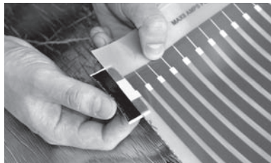
Рис. 8. Пример правильной установки изоляции линии отреза медной шины
