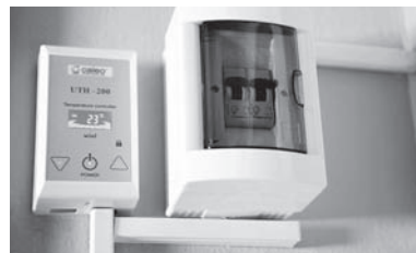
Рис. 20. Терморегулятор, подключенный к сети через отдельный автомат
